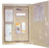
Coffret de branchement provisoire monophasé (P490 - P489)
