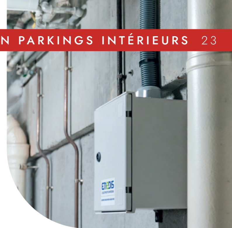
Exemple de coffret d'exploitation
