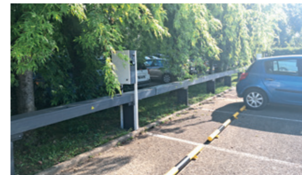
Exemple d'une installation intégrée à la végétation
